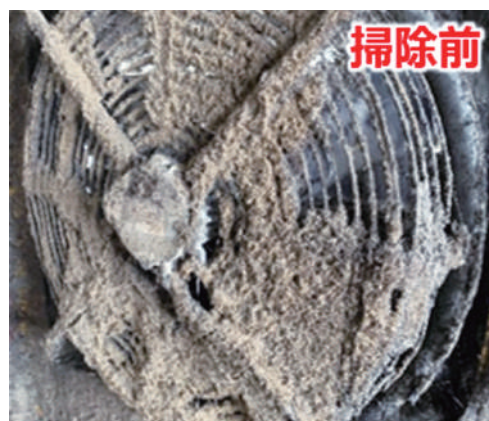
写真5 未清掃の送風機
